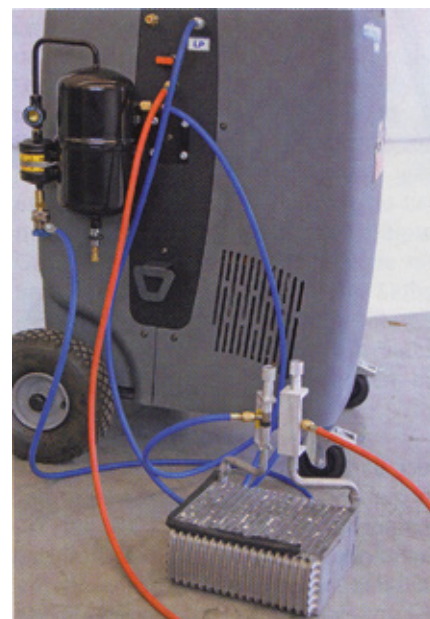
Das Spülen von einzelnen Bauteilen oder von Systemabschnitten ist beim Tauschen von Klimakomponenten unerlässlich.
